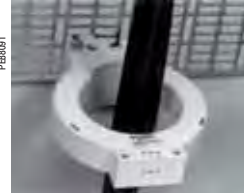
Установка на монтажной плате
